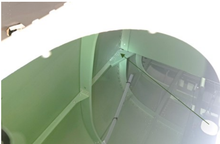
Obrázek 12 Chybějící nýt na levé straně instalované kontrolním otvorem na dně trupu
